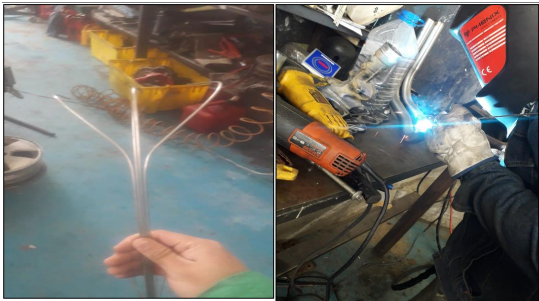
Figura 5. Esquema de forma de conductos del colector de escape y soldadura de los mismo con soldadura TIG.
