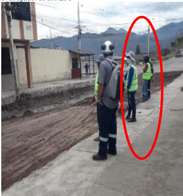
Figura 4. Trabajadores sin EPP
